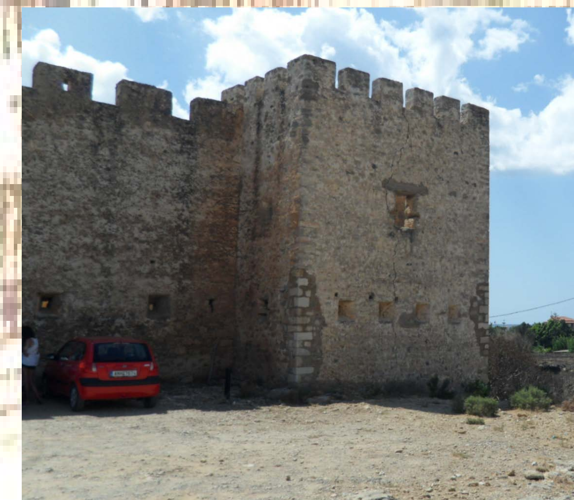
Εικόνα 6: Η ρωγμάτωση στο ΒΔ πύργο
